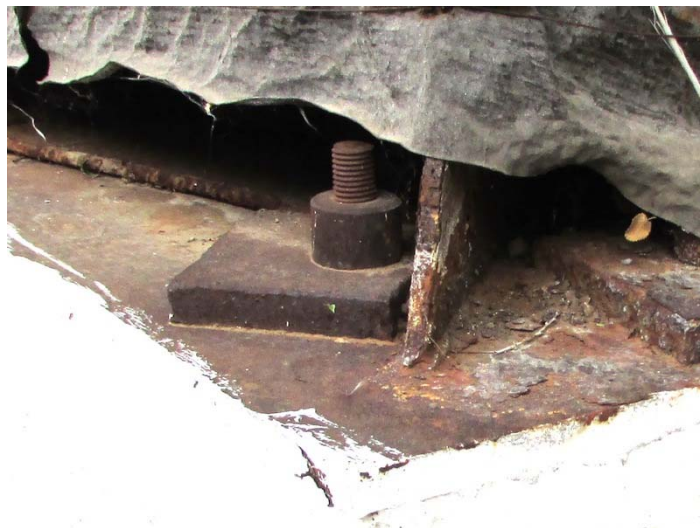
Рисунок 4 - Отсутствие контргаяк на анкерных болтах.
