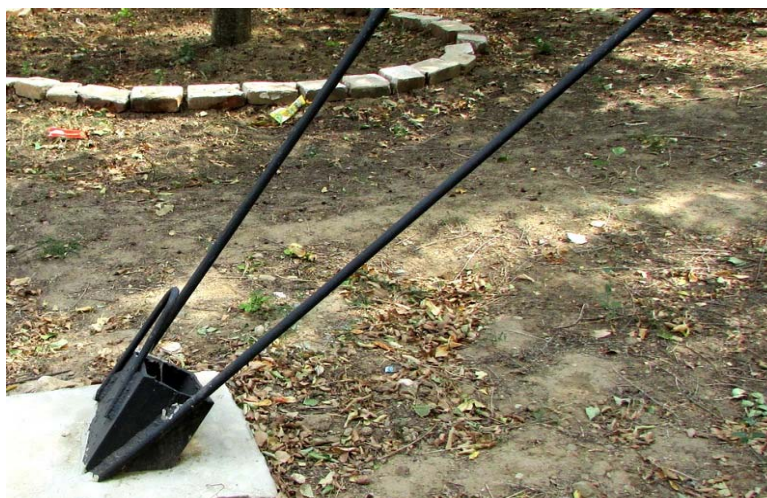
Рисунок 2 - Отсутствие натяжных устройств на растяжках.
