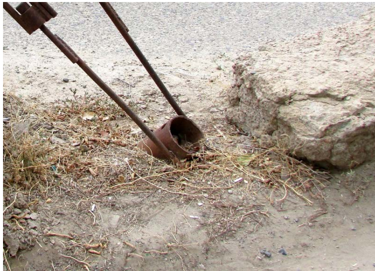
Рисунок 3 - Отсутствие вертикальной планировки земли вокруг анкерных фундаментов.
