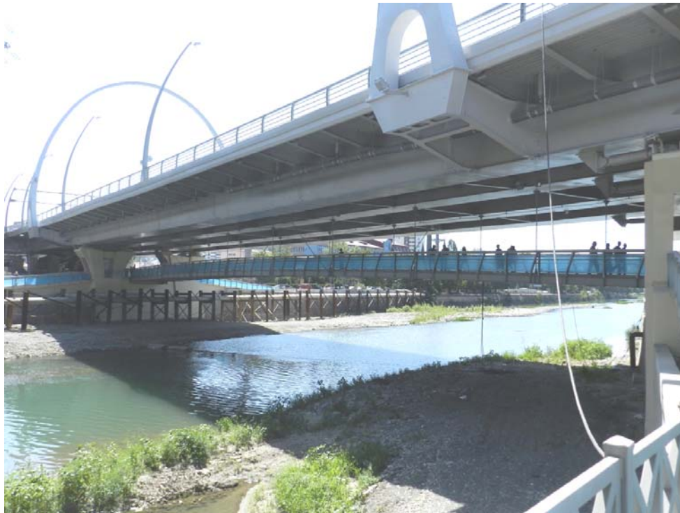
Рисунок 1 – Вид с правой стороны от конца моста. Общий вид моста по фасаду (фрагмент).
