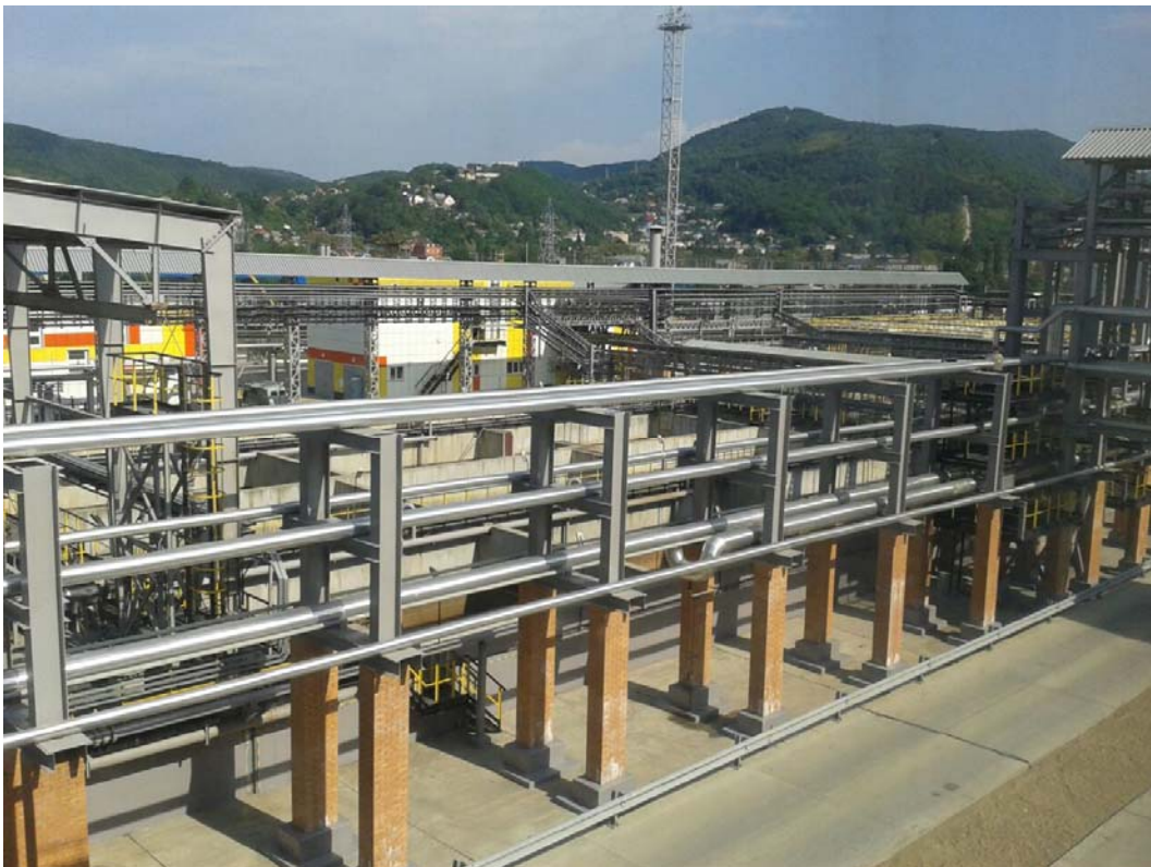
Рисунок 1 – Аэротенки очистных сооружений НПЗ
