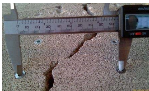
Рисунок 3 – Определение ширины раскрытия трещины по закрепленным маркам
