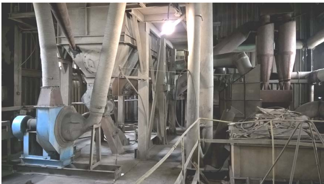
Рисунок 1– Установка по очистке отходящих от силоса газов на складе сухой золы (в правом верхнем углу циклон ЦН-15).
