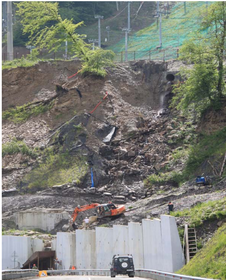
Рис. 4 – Ликвидация последствий размыва склона и подпорной стены водами поверхностного стока с «Роза–Плато» на гипсометрической отметке 1300 м, фото автора, май 2015 г.
