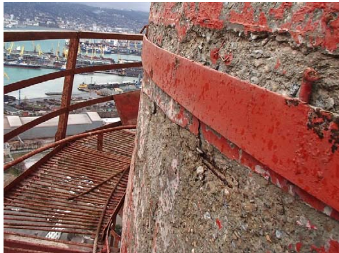
Рисунок 6 – Разрушение защитного слоя бетона с обнажением арматуры оголовка трубы.
