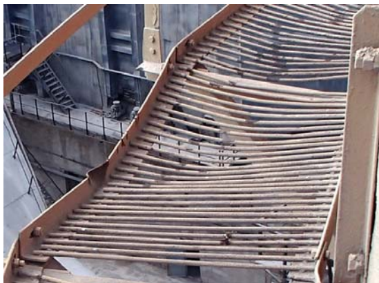
Рисунок 1 – Повреждение щита настила светофорной площадки падающим гололёдом.
