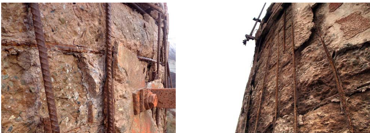
Рисунок 5 – Разрушение защитного слоя бетона с обнажением и выходом из строя рабочей арматуры оголовка трубы.
