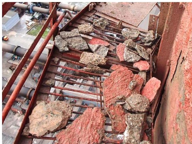
Рисунок 7 – Наличие мусора на светофорных площадках.
