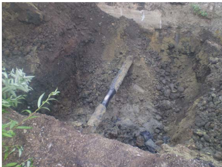
Рисунок 1 – Оценка технического состояния подземного газопровода в месте выявления повреждения изоляции при шурфовом диагностировании.
