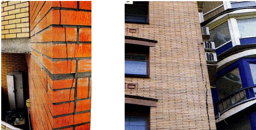
Рисунок 2 – Трещины в облицовке фасадов наружных многослойных стен многоэтажных зданий (вертикальные и горизонтальные деформационные швы не предусмотрены проектами: ширина раскрытия трещины 5 мм)
