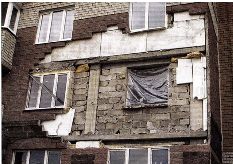
Рисунок 1 – Обрушение облицовочного слоя бетонных камней на 1–3-м этажах жилого здания
