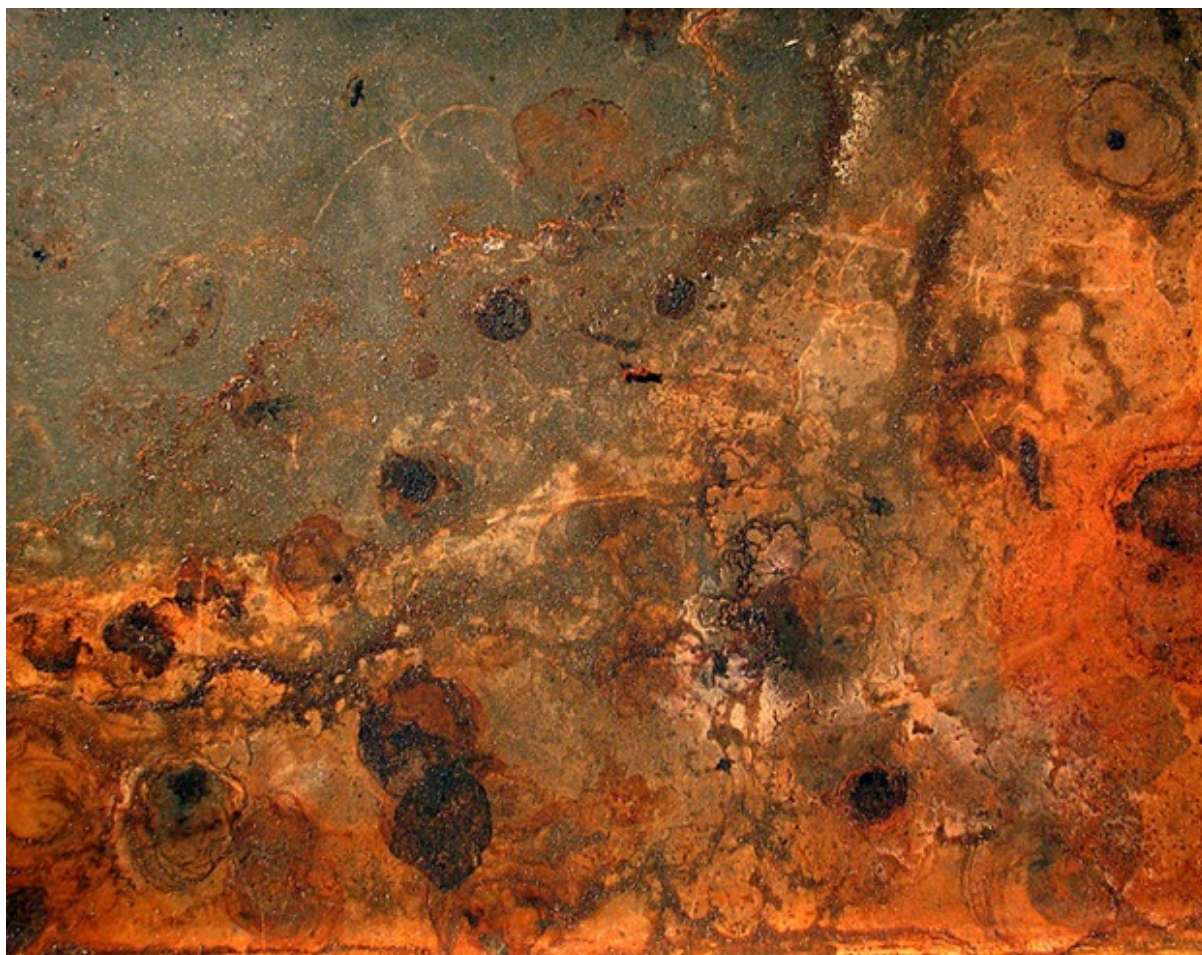
Рис.2. Распространение межкристаллитной коррозии на внутренней поверхности нижнего барабана парового котла ДЕ-25-24-380ГМО.
