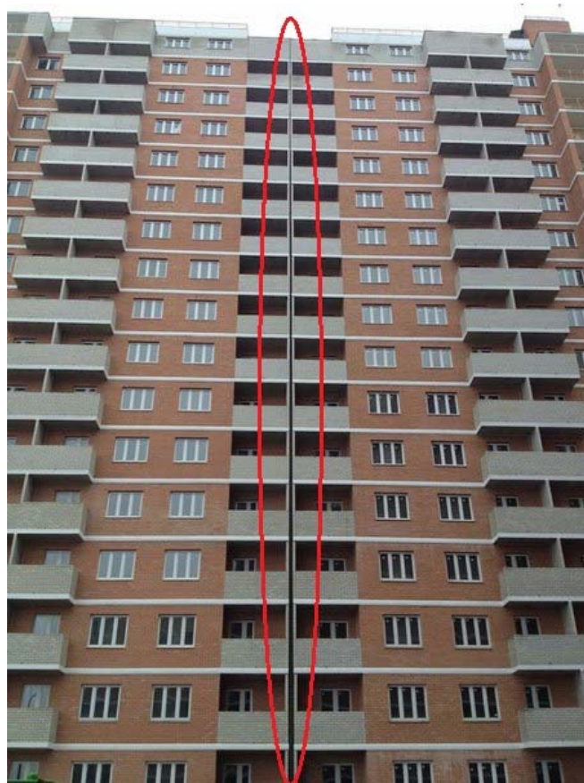
Рисунок 7 - осадка здания в Краснодаре.
